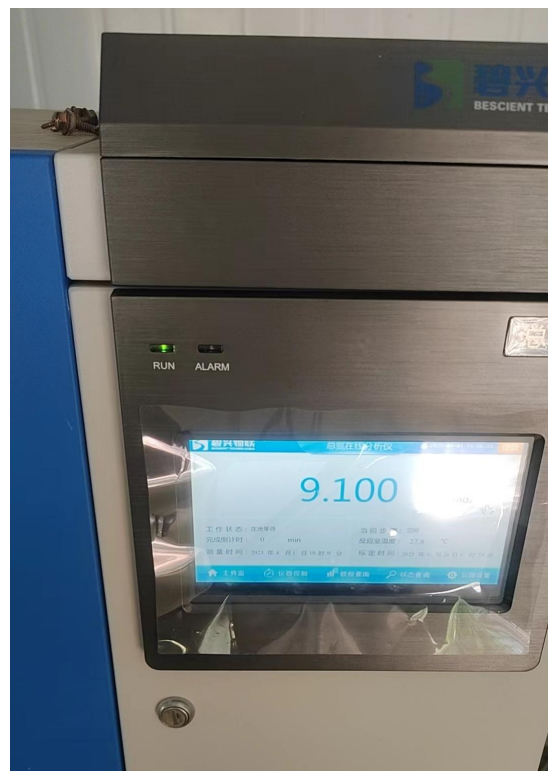
出水总氮在线
