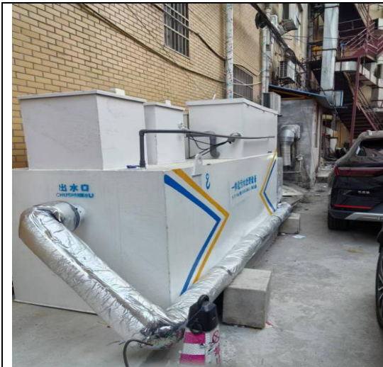
院内污水处理站
