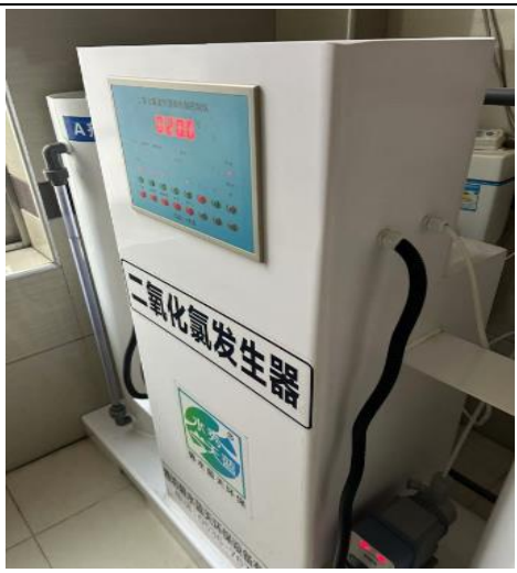
配药间二氧化氯发生器
